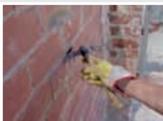
Agarre inadecuado de la piqueta
