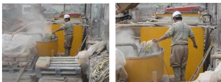
Polvo generado en la alimentación de la mezcladora
